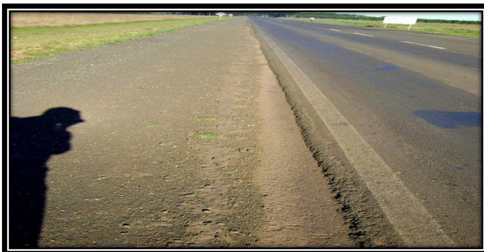
Foto 4 - Descalce de Banquina – Lado Ar.
