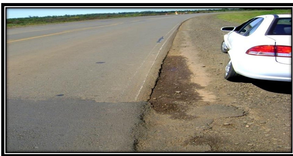
Foto 3 - Descalce de Banquina – Lado Br.
